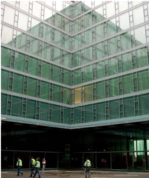
Fasáda v átriu bola tiež riešená ako fasáda z elementov na výšku celého podlažia
